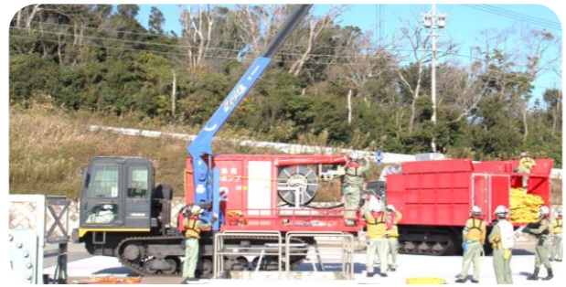
原子炉を冷やすための可搬型注水設備の設置（現場）
