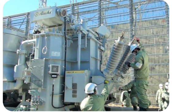
代替受電ルートの健全性確認試験
