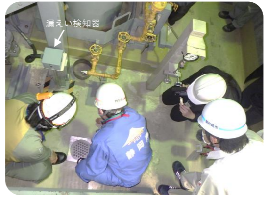
漏えい検知器の現場確認状況
