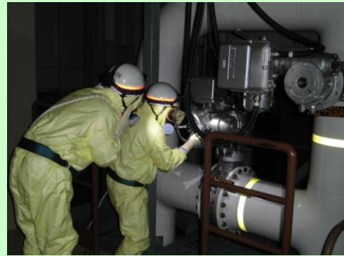
格納容器ベントラインの作成 (建屋内の照明を消灯して実施)
