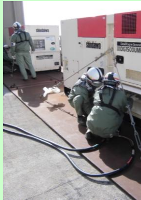
災害対策用発電機による電源確保 (建屋内の照明を消灯して実施)
