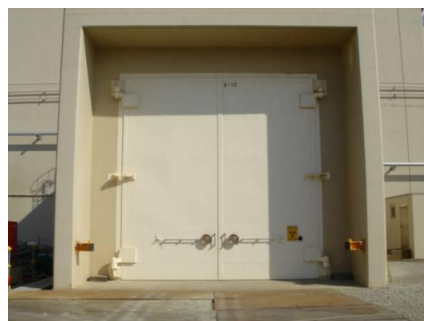
3号機 大物搬入口の例
