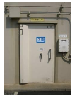
3号機 防水構造扉の例
