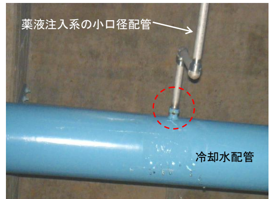
漏えい箇所 (配管接合部付近から漏えい)
