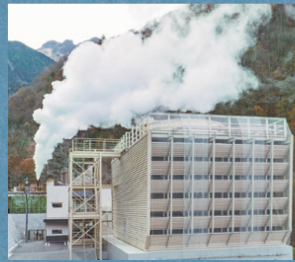
岐阜県「中尾地熱発電所」
