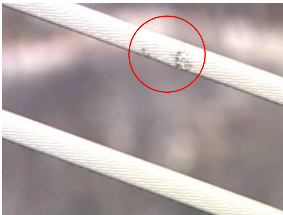
信濃東信線No.2～No.3 1号線 中線 No.2 より 140m 地点
