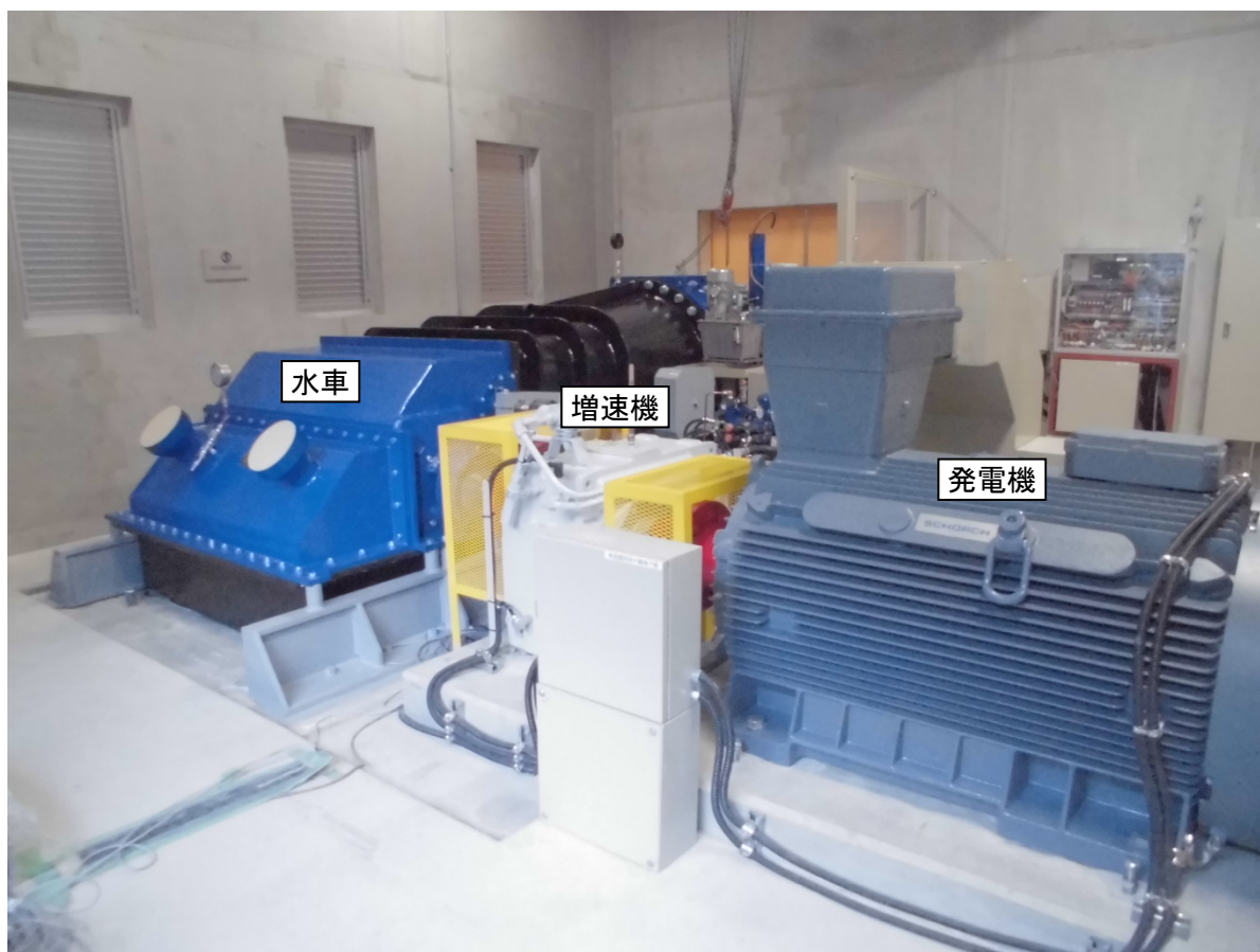
水車発電機近景
