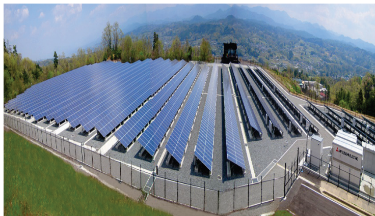
飯田市と中部電力との共同実施による メガソーラー発電所
