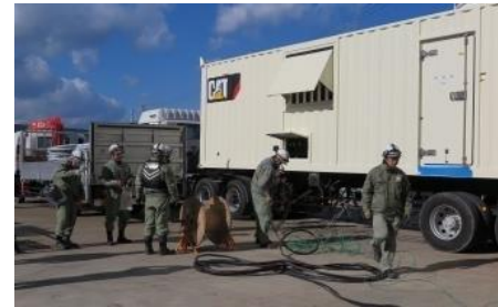
・ 電源車操作訓練
