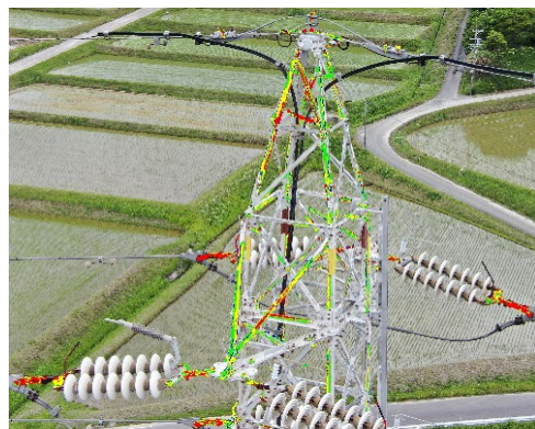
自動異常検出AIによる鉄塔錆点検
