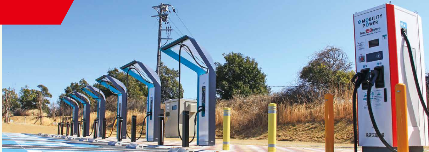
浜松サービスエリア(下り)のEV急速充電器 e-Mobility Power
