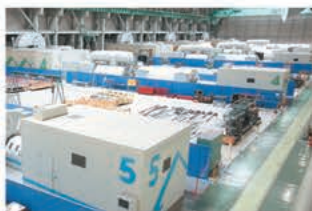
中部電力 川越火力発電所 タービン建屋内
