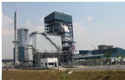
籾殻発電設備(タイ国北中部ピット県)
