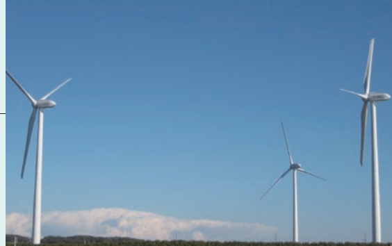
御前崎風力発電所(1期)
