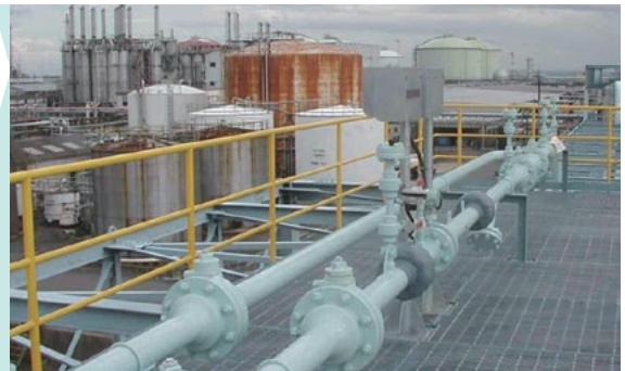
ガス供給設備
