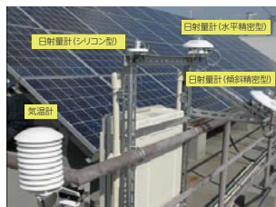
営業所屋上に設置した日射量等測定装置と既設の太陽光パネル
