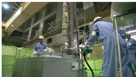
MOX燃料受取検査の様子
