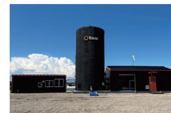
Eavorの実証プラント(カナダ・アルバータ州)
