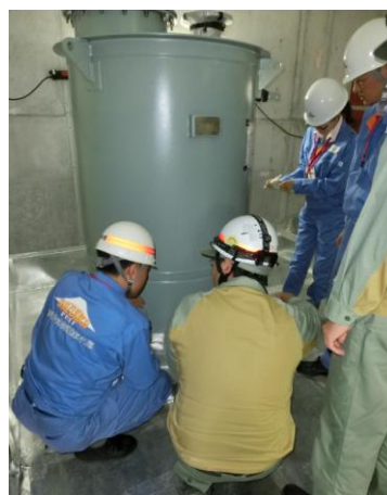
緊急時淡水供給設備設置工事(燃料タンクの設置) 点検の様子
