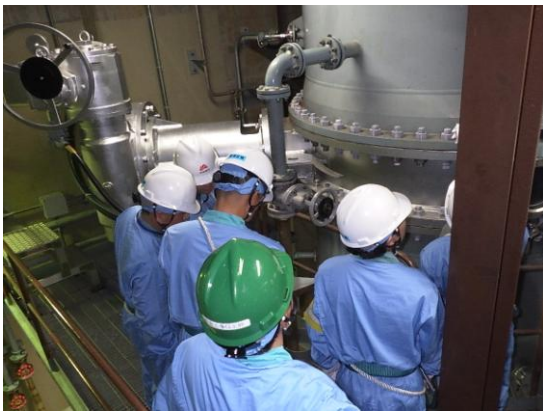
循環水系からタービン建屋内への溢水防止対策 (隔離機能の追加)点検の様子
