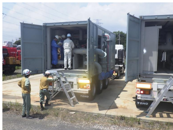
可搬設備の確保 点検の様子
