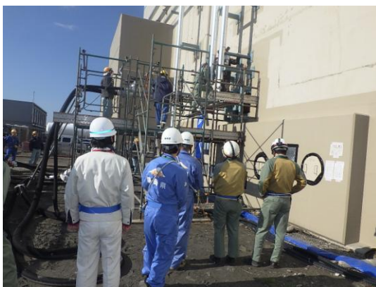
水源の多様化(緊急時淡水貯槽の設置) 点検の様子
