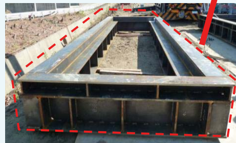
基礎部掘削用のガイドウォール ガイドウォールの内側に大型重機(掘削機)を設置し、掘削するための定規となる治具です。
