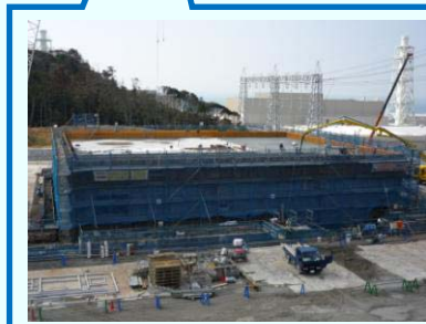
緊急時電気品建屋(電源盤)
