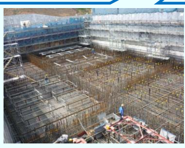
燃料タンク設置エリア
