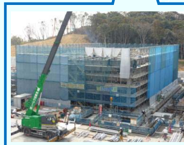
ガスタービン発電機建屋
