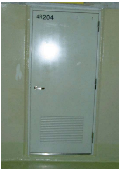
水密化されていない扉
