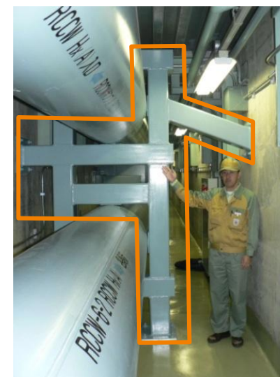
配管サポートの例
