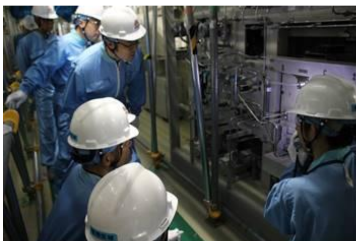
フィルタベント出口配管への水素濃度計の設置状況確認の様子
