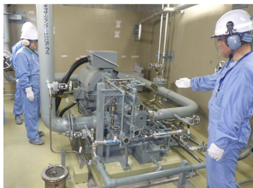
燃料プール冷却浄化ポンプを確認している様子
