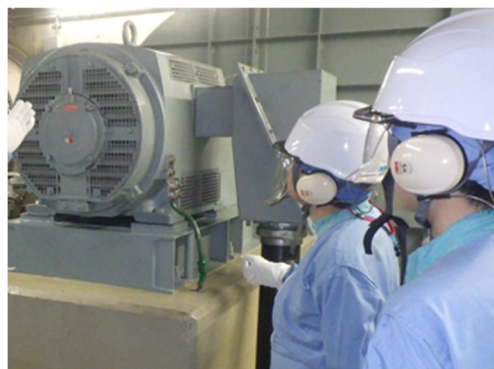
原子炉建屋の空調設備を確認している様子
