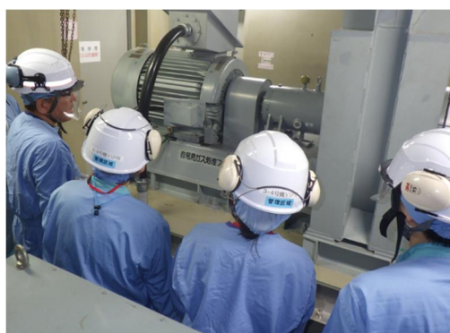
非常用ガス処理ファンを確認している様子
