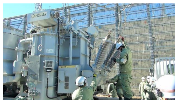
代替受電ルートの健全性確認試験の様子
