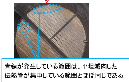
図2 熱交換器内の管板の状況 (丸穴は伝熱管の端部)
