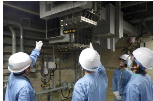
浸水防止ダンパの点検の様子
