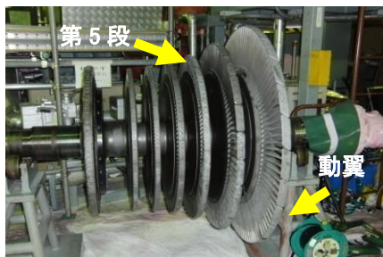
給水ポンプ駆動タービン(4号機)
