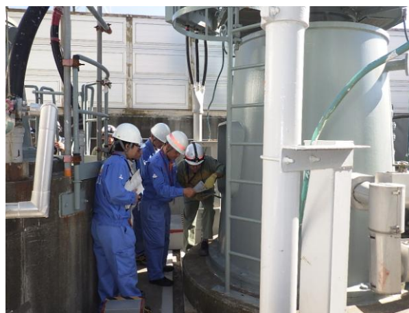
海水ポンプ軸受注水の無注水起動対策点検の様子
