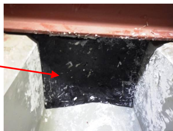
適切な分離板の設置状態
