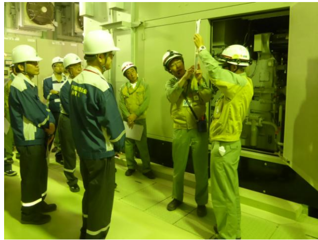
現地視察の様子(緊急時ガスタービン発電機)
