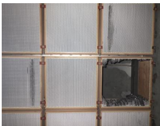
破損した塩分除去フィルタ (横からみた様子)
