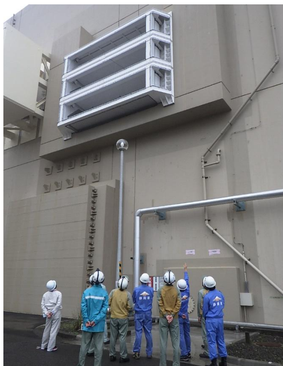
原子炉建屋空調開口部への自動閉止装置 点検の様子
