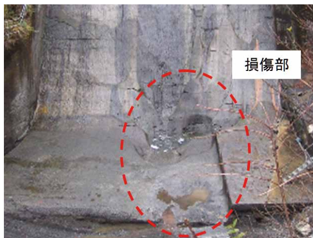
第1図 ダムの洪水吐の損傷状況の例
