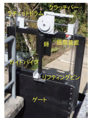
第3図 現地設置状況 (カバー取外し)
