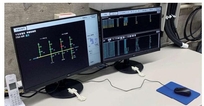
(d) SCADA画面 第3図 IEC 61850を適用した変電所監視制御システム
