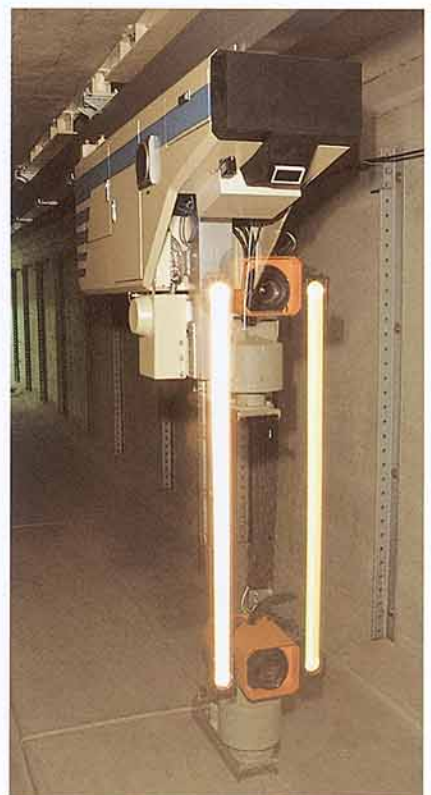
ケーブル棚を隅々まで映像監視 テレビカメラ バン320° チルト上下各45° カメラの雲台 1m下降
