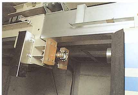
レール終端部に設けた充電用カップラにロボットがドッキングして自動充電
