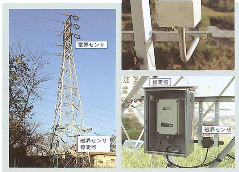
第3図 故障区間標定装置
