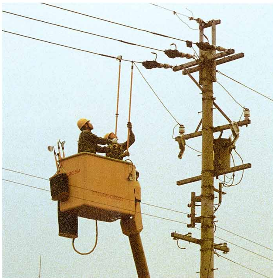
第1図 ホットスティックによる引き下げ線着脱工法の概要
