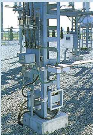
■避雷器漏れ電流センサ 素子の劣化時に増加する漏れ電流を三相一括して検出
