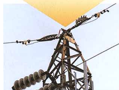
地絡点表示器取付状態
