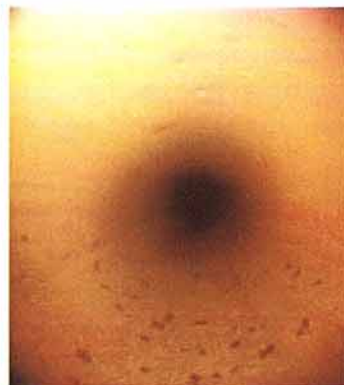
第2図 細管内面スケール付着状況(洗浄後)
