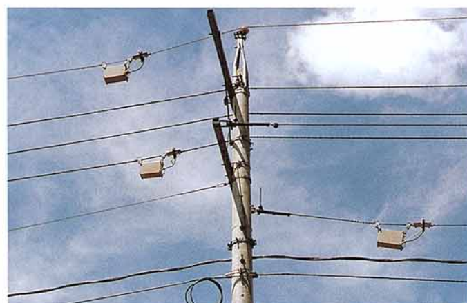
第3図 記録形雷電流波形測定装置取付状況
