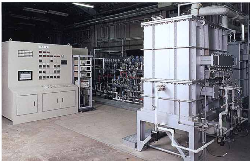
第7図 1kW級固体電解質型燃料電池
