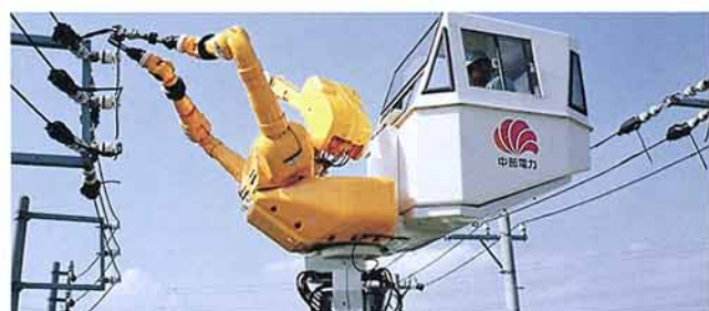
第1図 3号機マニピュレータシステム
