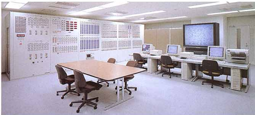
第4図 オペレーション室
