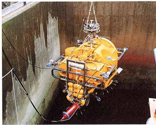
第9図 取水路清掃ロボット
