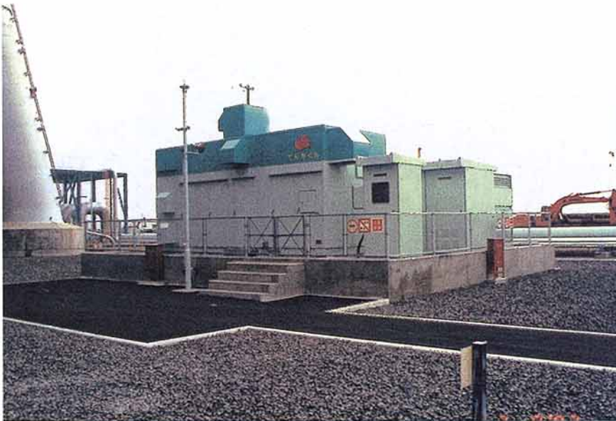
第3図 川越火力発電所構内の燃料電池
